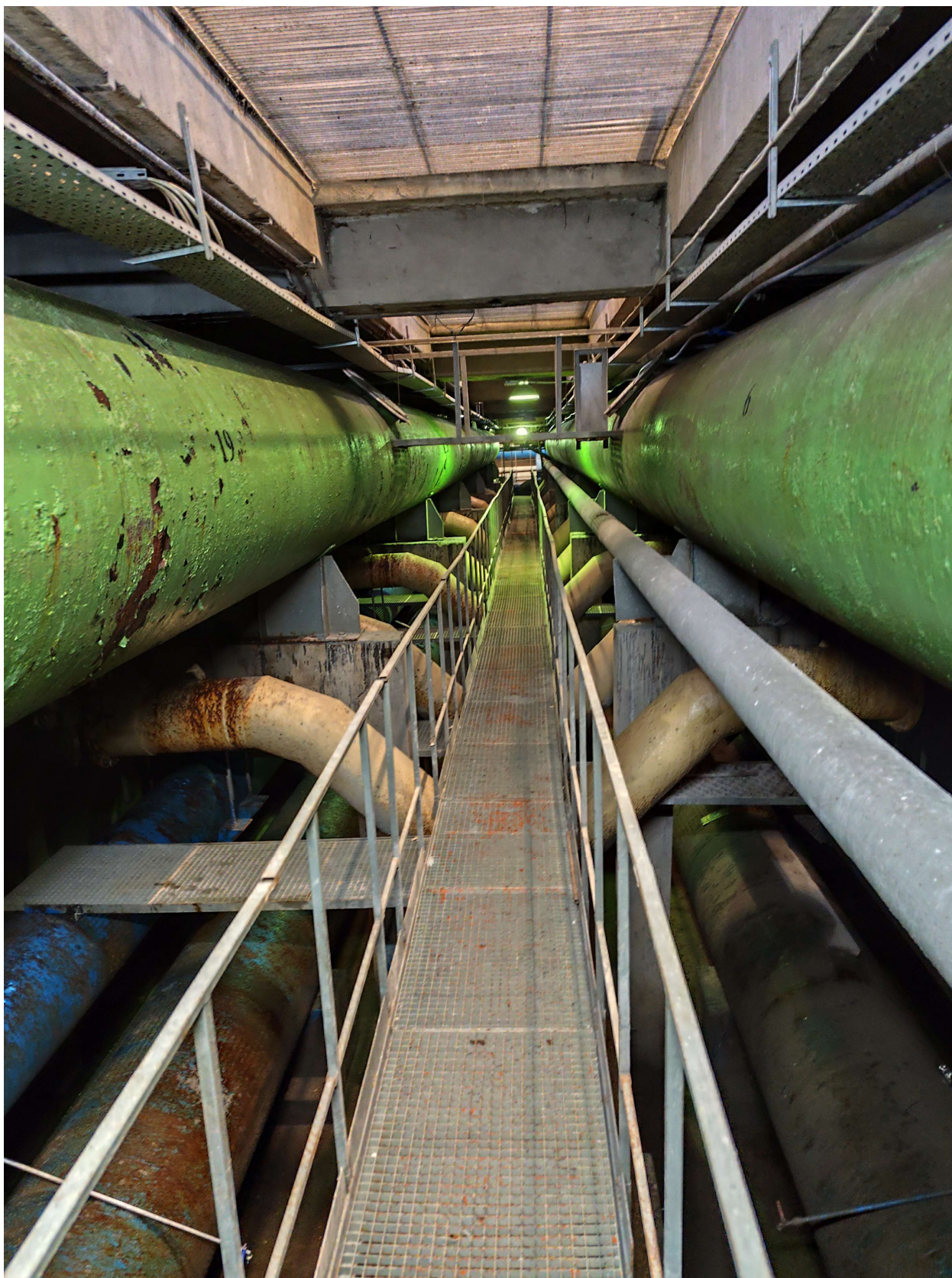
Widok kładki technologicznej i rurociągów do wymiany
